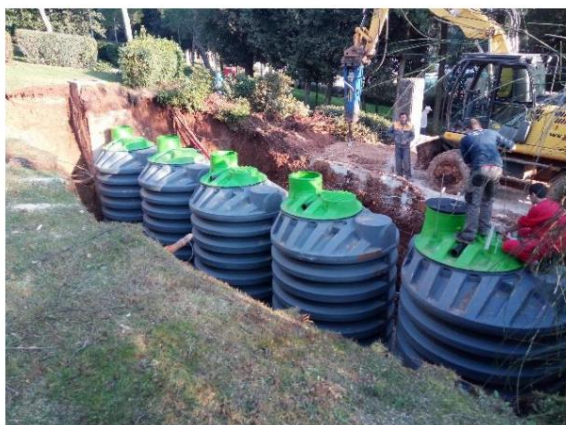
Photo 5 : Réservoirs installés en rangée
